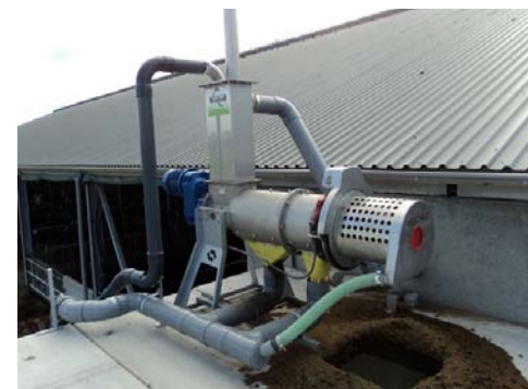
De scheider kan op verschillende manieren worden geplaatst. Hier een Sepcom scheider op het dak van de voorraadbunker.
